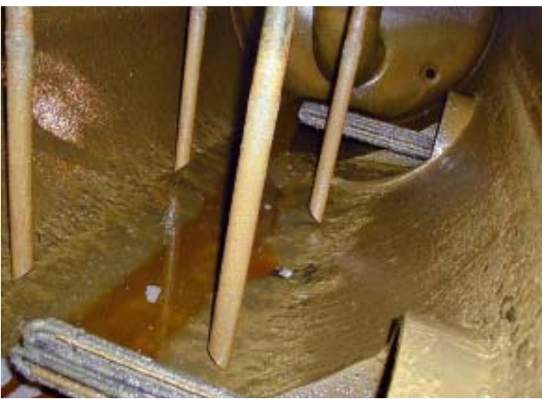
Ölbehälter eines Prozessgaskompressors, belegt mit grünlichem Schlamm durch Reaktionen zwischen Schmieröl und Prozessgas
