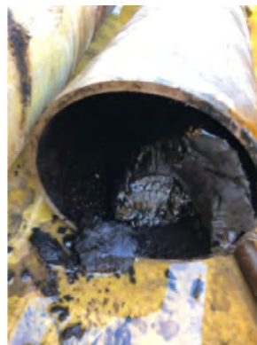
Foto dei depositi di carbonio del sistema di trasferimento calore
